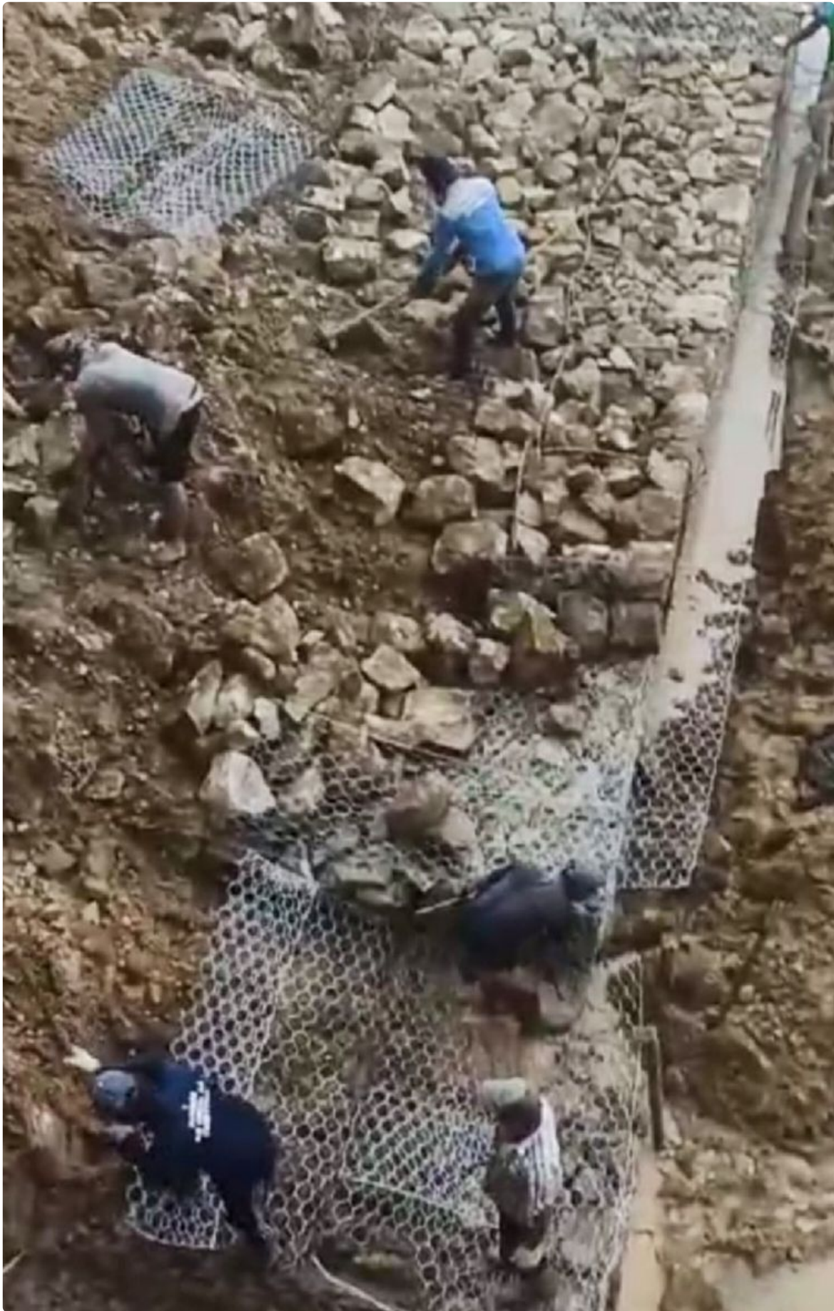
"Akibat longsor tembok setinggi belasan meter ambruk dan diganti dengan pemasangan Bronjong yang dikerjakan sejak sebulan lalu," kata pria berinisial Z
